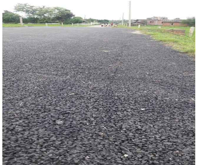
टीकापुर नगरपालिका वडा नम्बर १ ज्योतिनगर जाने पीच बाटो । जो चर्किसकेको छ ।
